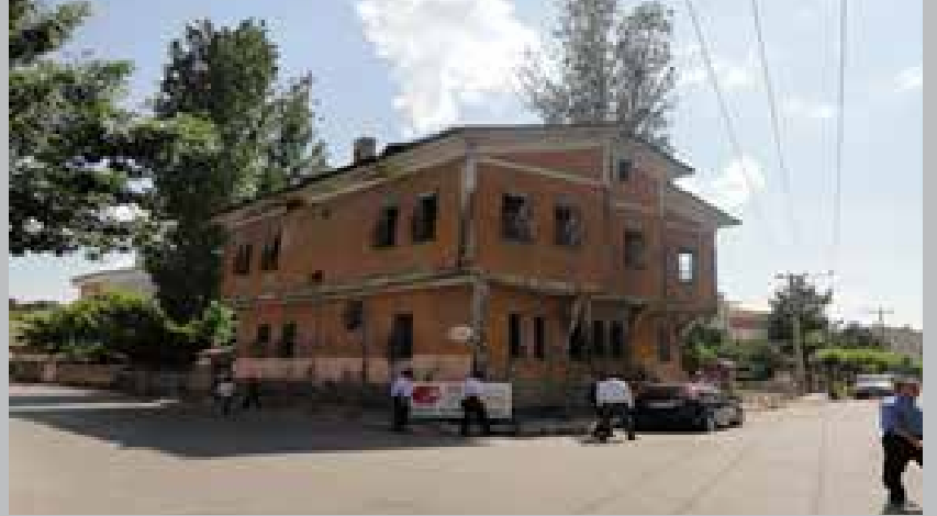
Resim 2. Sivas Yatırım Destek Ofisi Geçici Hizmet Binası ve Restorasyonu Süren Hizmet Binası
